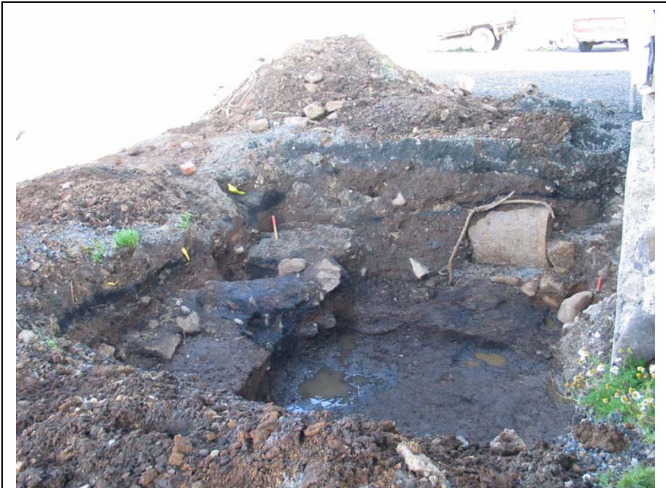
Mynd 3 (horft í NA, 3 m eru á milli hælanna). Austurhlíð er röskuð af framkvæmdum u.þ.b. 1,4 m niður (niður að bálkinum sem tunnann liggur á. Steypt skolprör stendur út úr sniðinu milli tanksins og hæsins vinstra megin á myndinni. Í brúninni á bálkinum lá steinsteypni sökullinn og þar í sjást samanþjöppuð gólflög.
